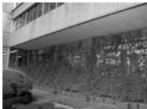
市役所本館新館連絡通路に作られた緑のカーテン
